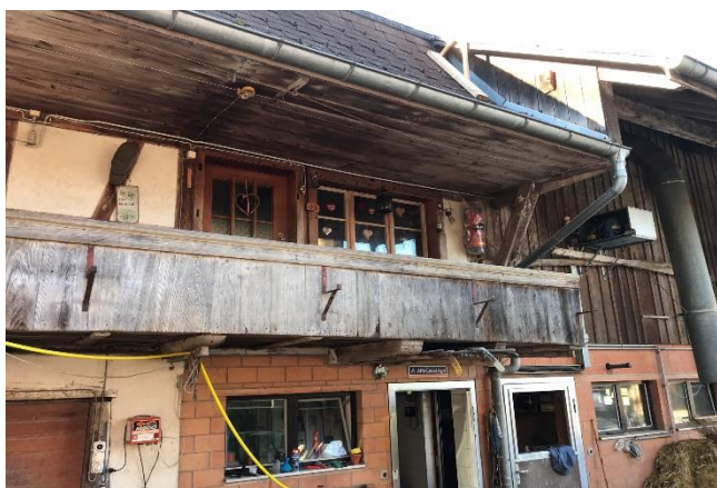
Hier braucht es dringend ein neues Wohnhaus.
